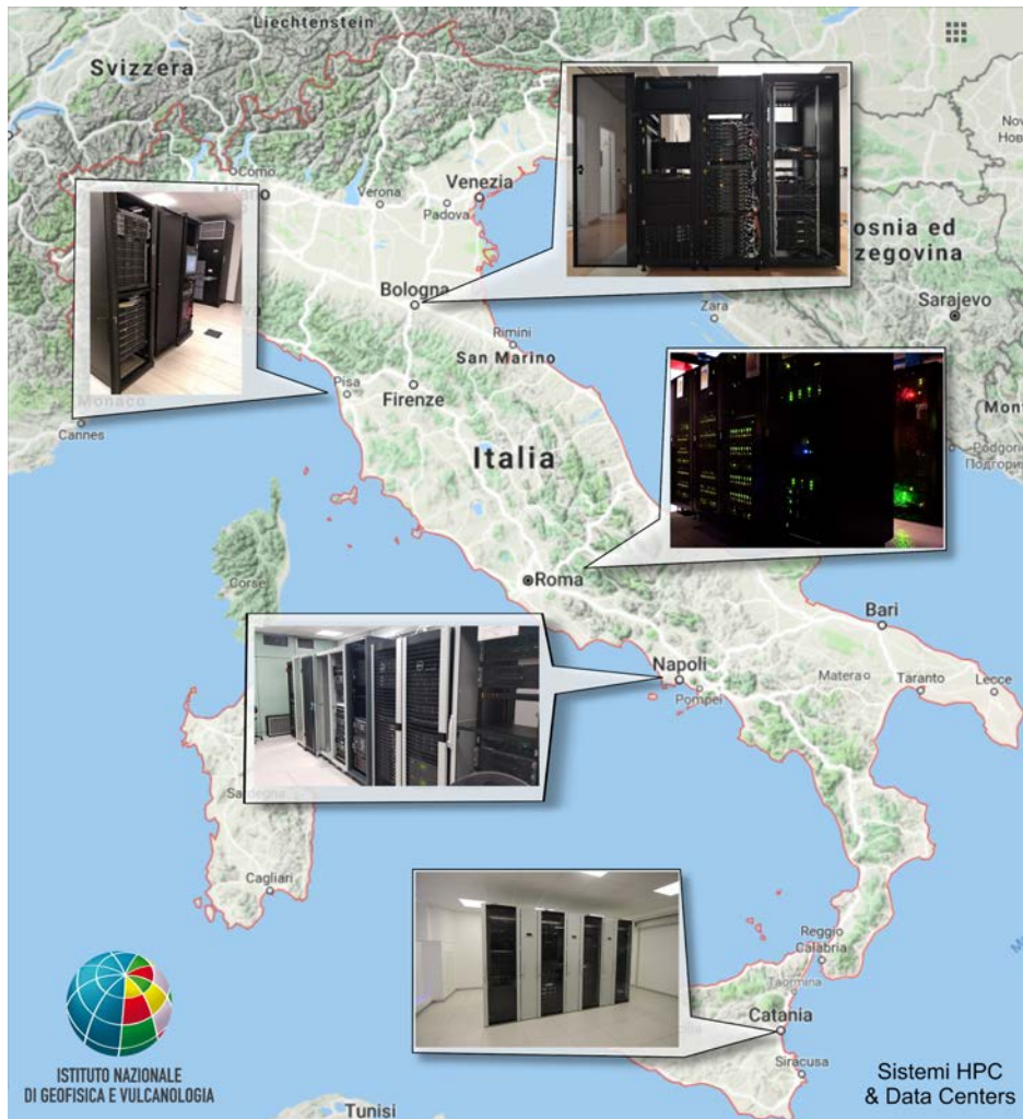
Figura 16.11 Principali centri HPC e Data Centers INGV.
